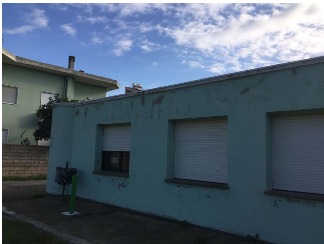
Foto 6 Intonaco complessivamente da risanare
