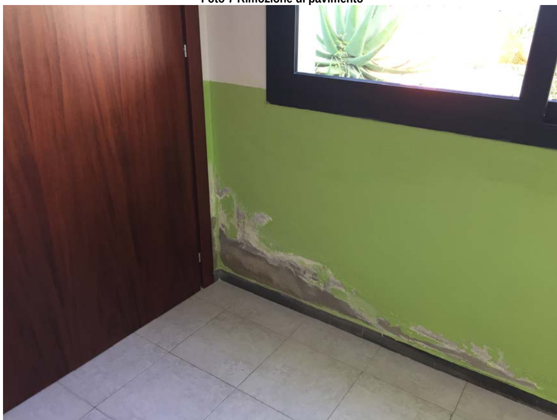
Foto 8 Tamponatura da risanare
