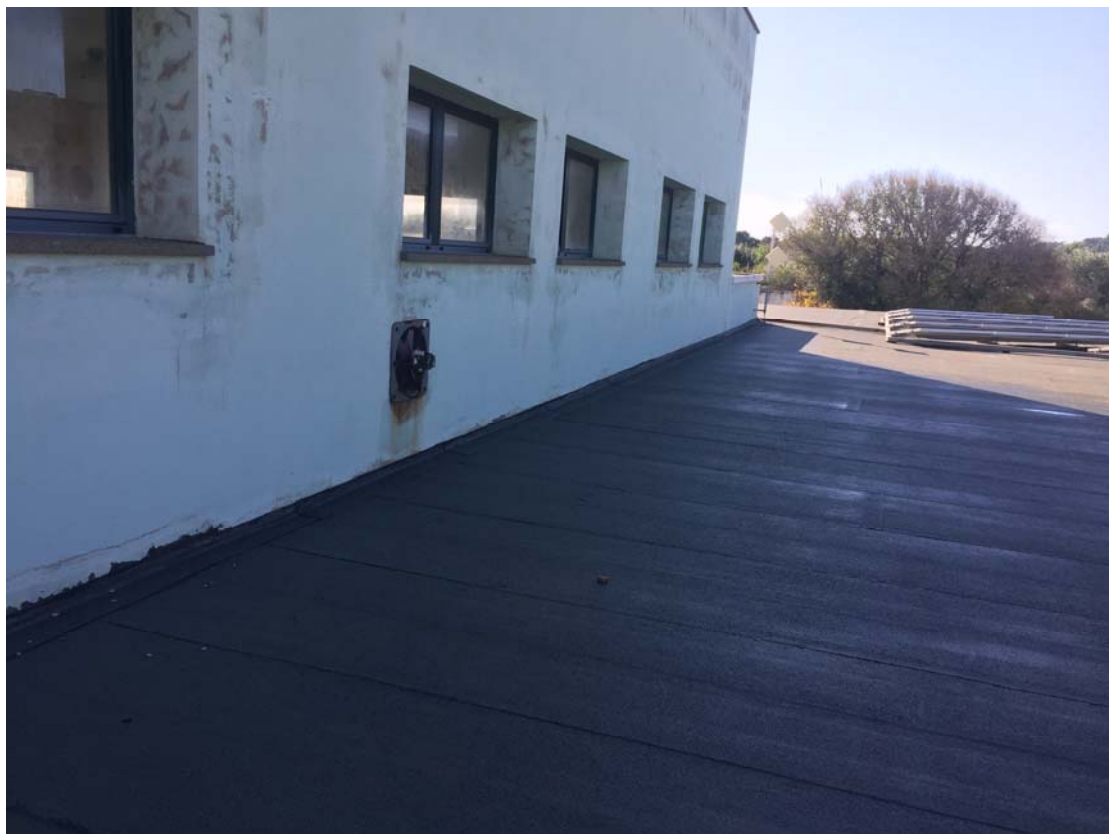
Foto 3 Impermeabilizzazione da ripristinare
