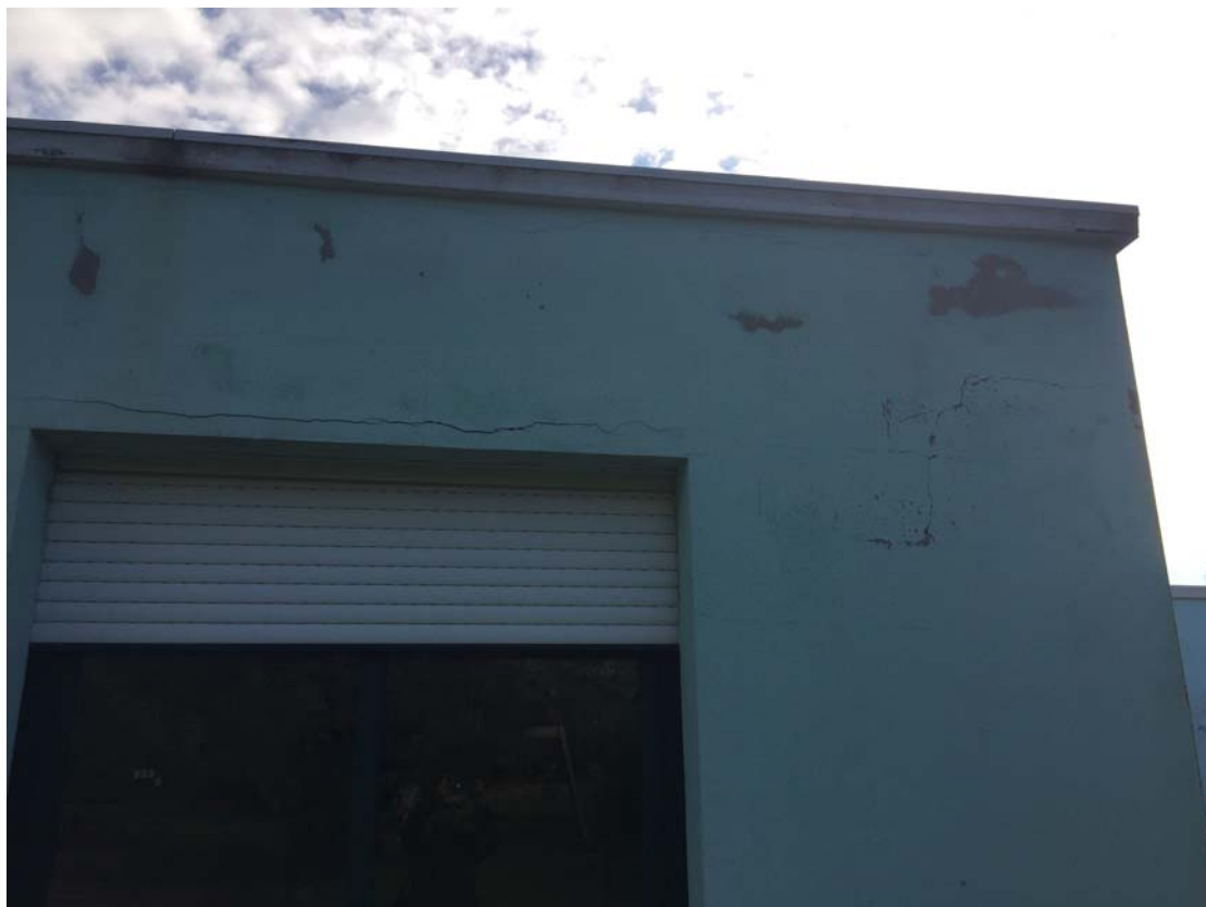
Foto 5 Intonaco parte alta da risanare
